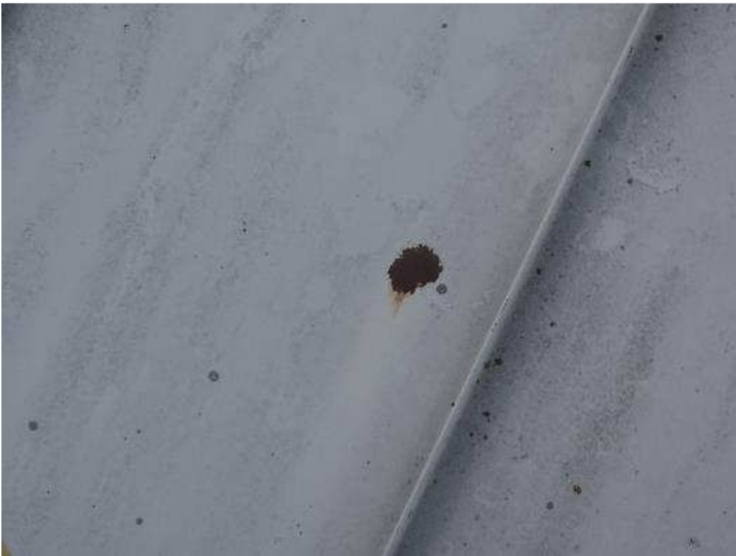
Kuva 100. Vesikatteessa havaittiin lievää paikallista korroosiota.
