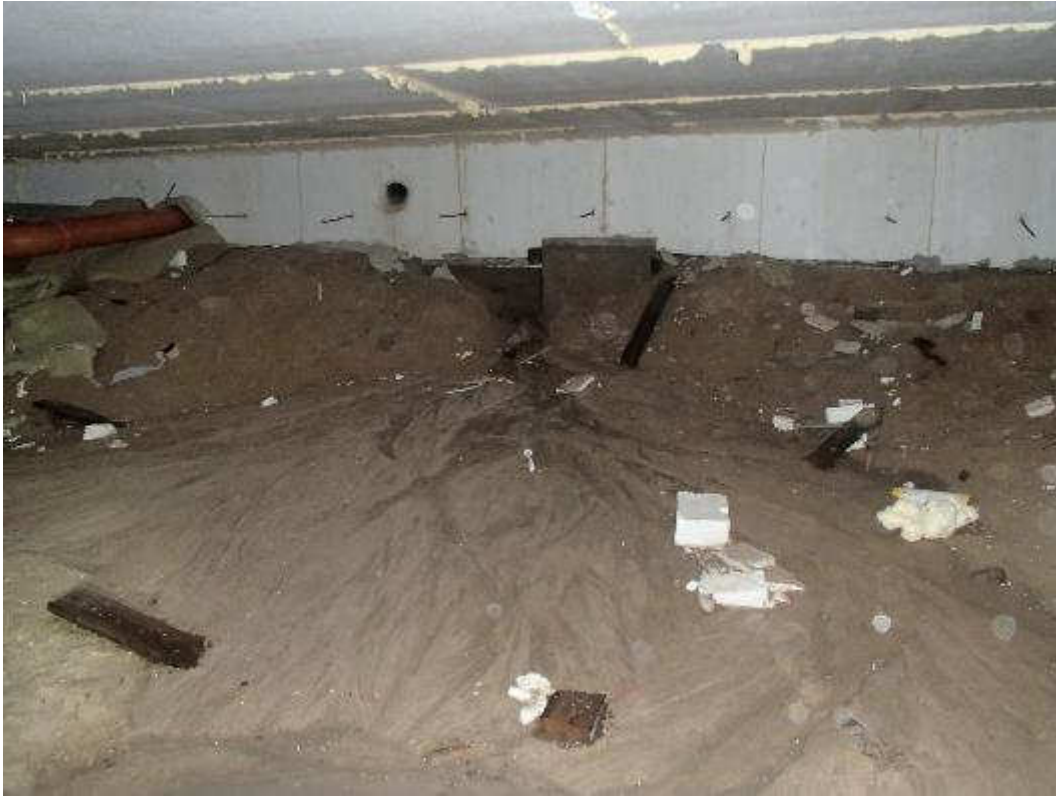
Kuva 117. Sade- ja sulamisvedet valuvat ryömintätilaan sokkelin edestä.
