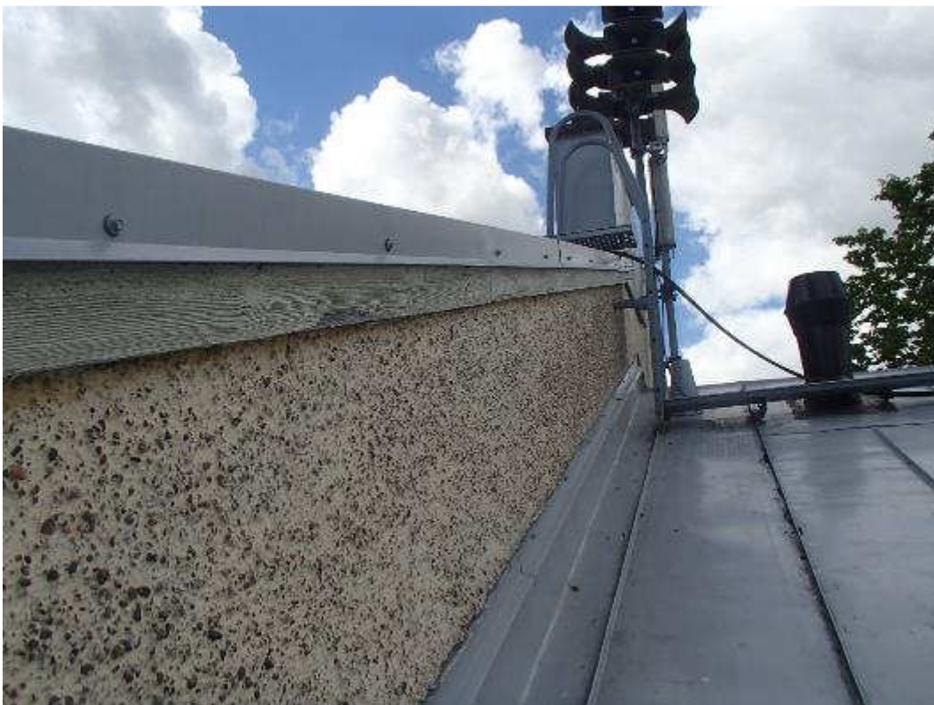
Kuva 29. Paikoin otsalaudoitusten maalipinnat ovat ikääntyneet.
