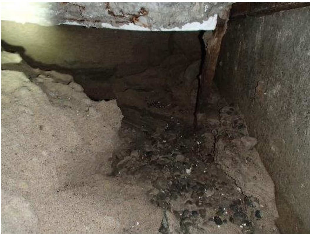
Kuva 118. Sade- ja sulamisvedet valuvat ryömintätilaan sokkelin edestä.
