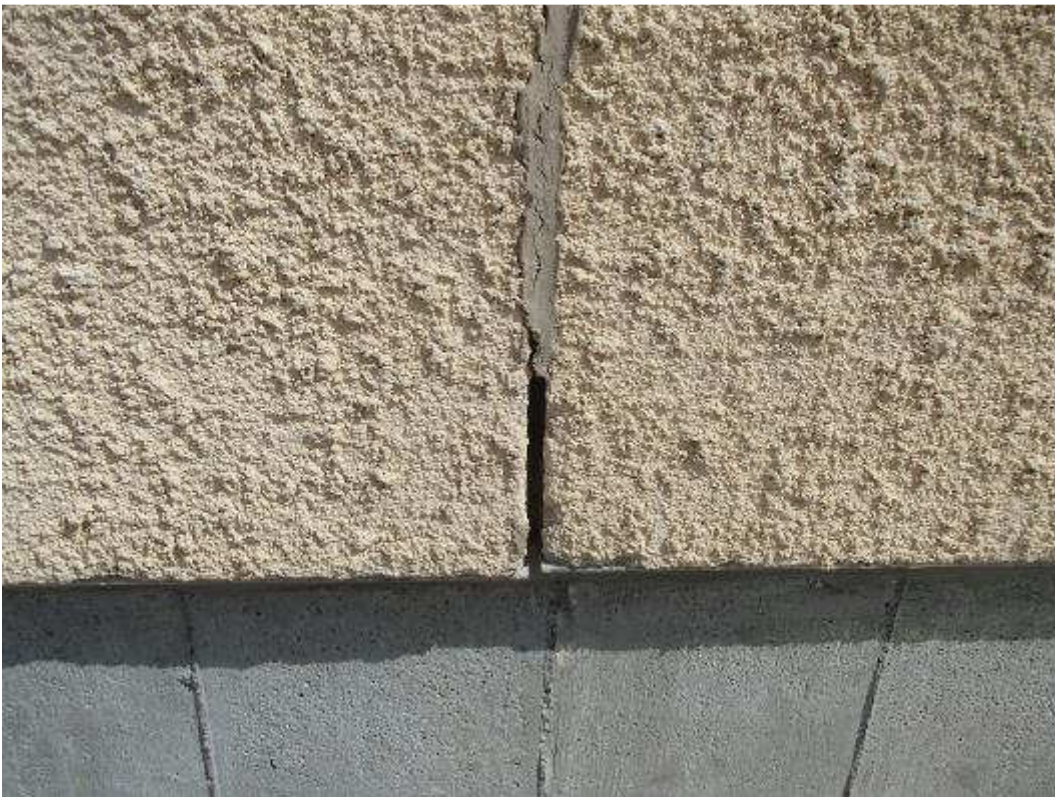
Kuva 127. Julkisivujen elastiset saumamassat ovat ikääntyneet.
