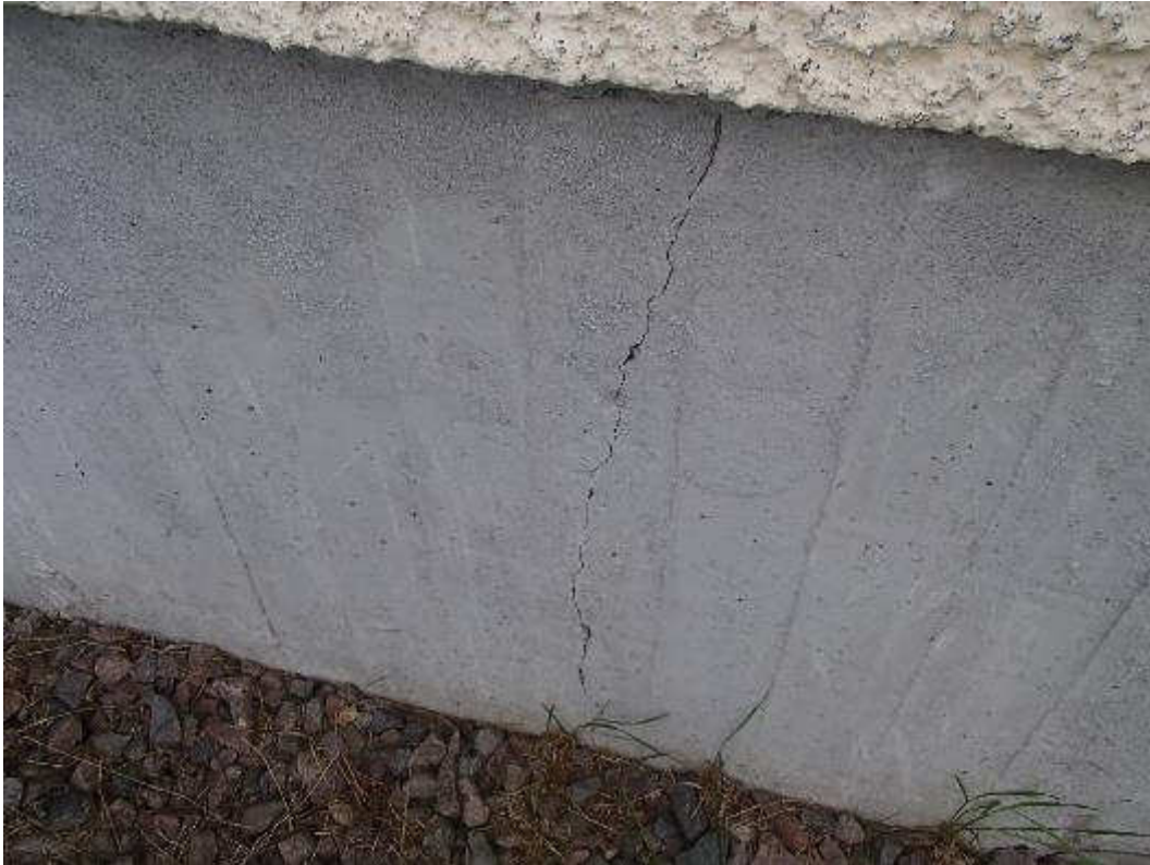
Kuva 90. Sokkelissa havaittiin pystysuuntaista eikä sokkelin yläpinnassa havaittu vesieristystä tai perusmuurilevyjä.
