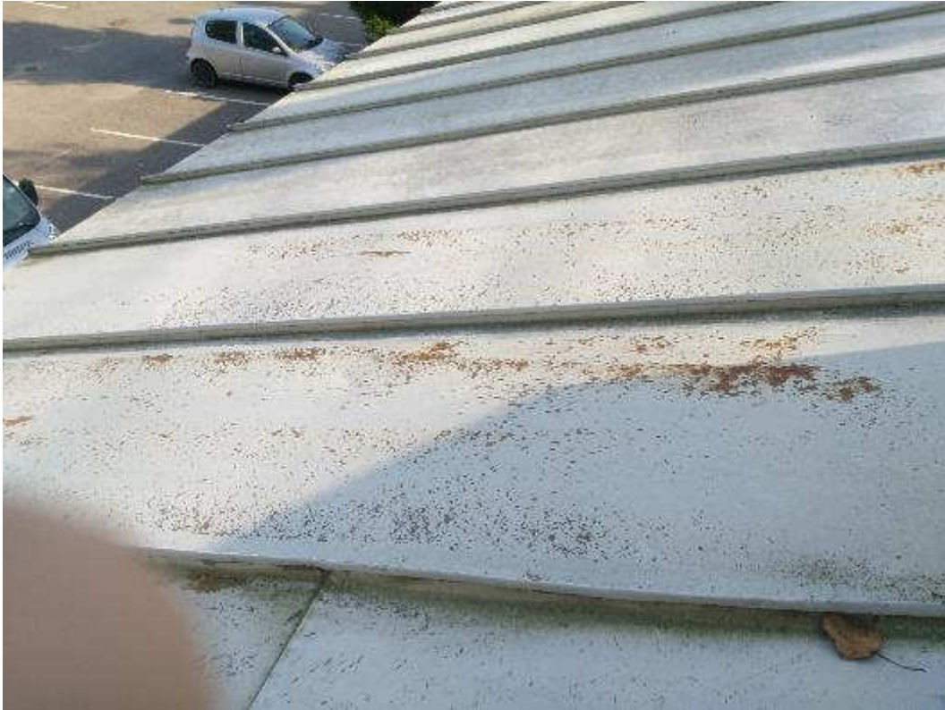
Kuva 26. Vesikatteessa havaittiin paikallista korroosiota.
