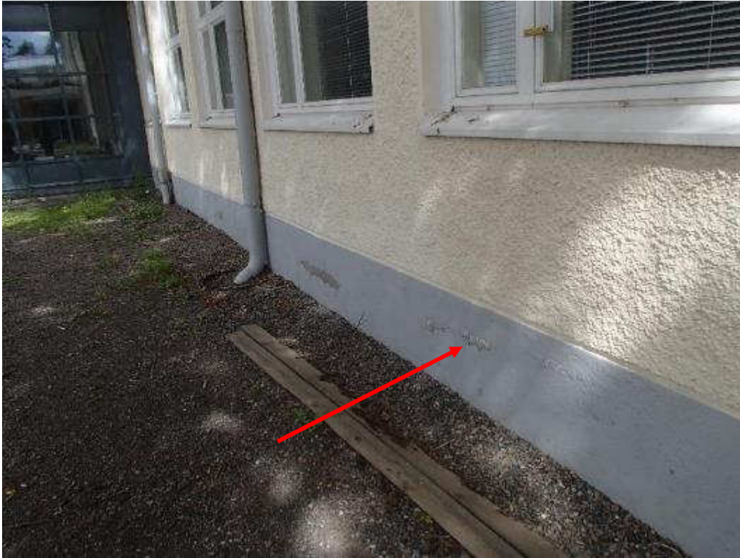
Kuva 17. Sokkelissa on havaittavissa kalkkihärmekertymiä.
