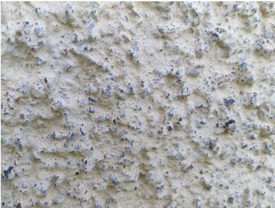
Kuva 81. Paikoin julkisivujen maalipinnat ovat kuluneet.
