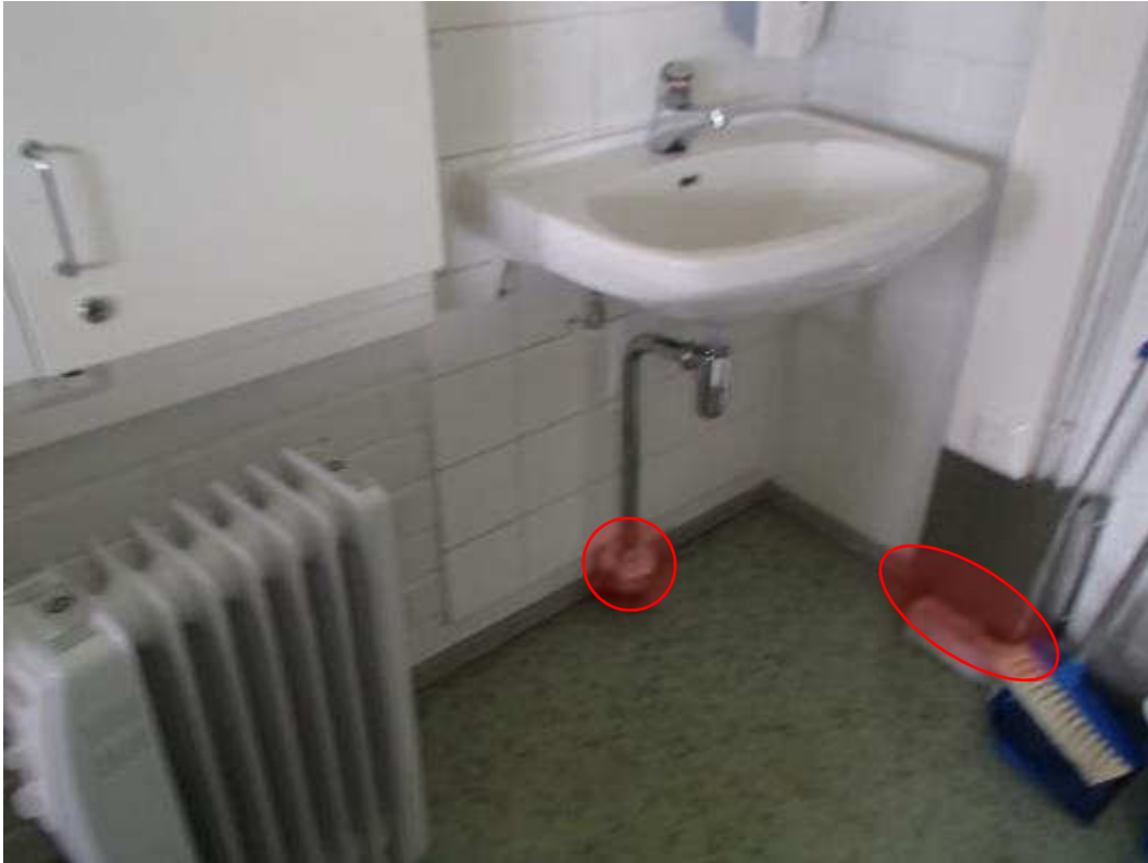
Kuva 140. Alapohjan tyypillisimmät epätiiveyskohdat.
