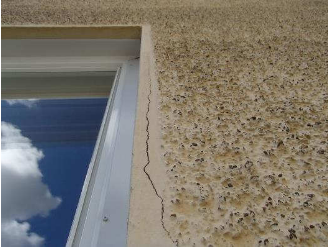
Kuva 7. Rakennuksen rappauspinnoissa havaittiin paikoin halkeilua.
