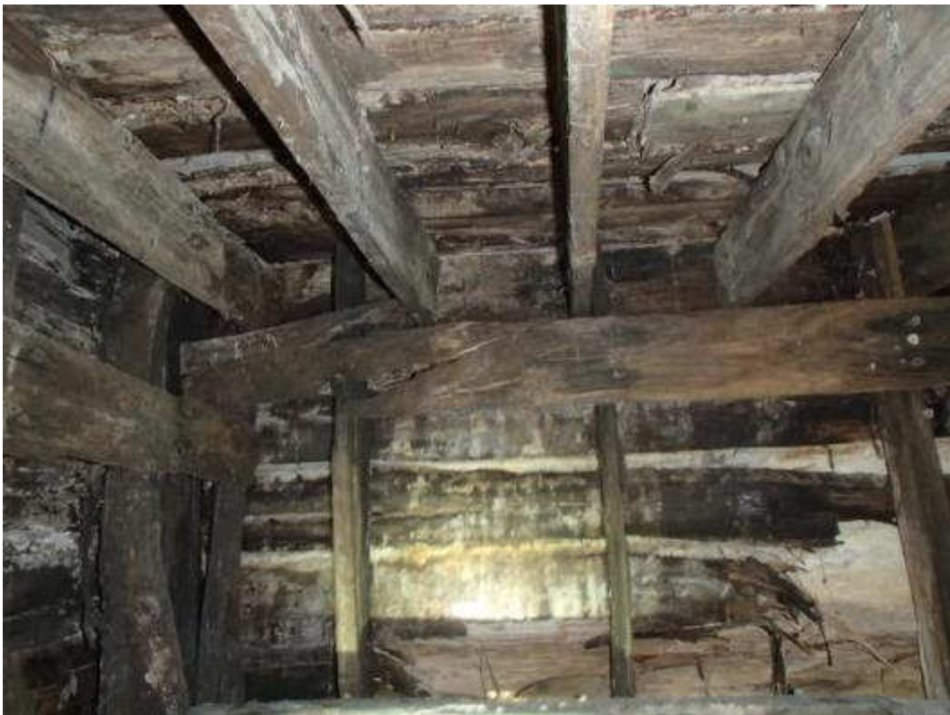
Kuva 73. Esikoulun alapuoleisen ryömintätilan muottilaudoitukset ovat pahoin vaurioituneet.
