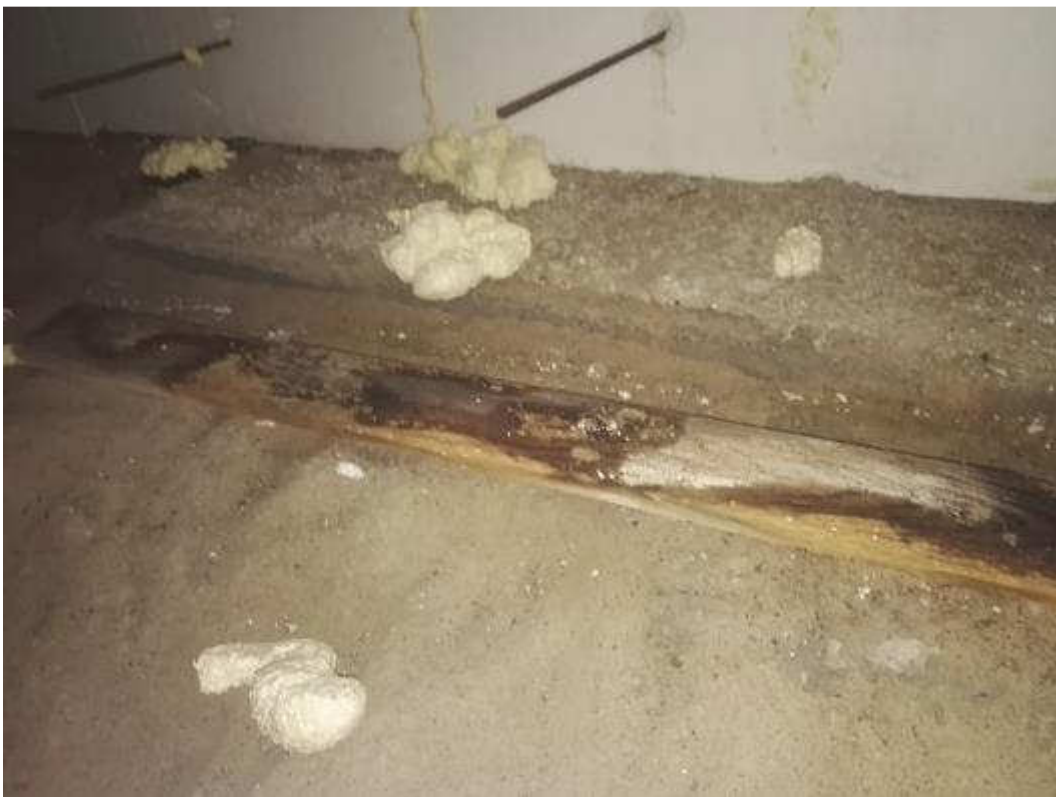
Kuva 112. Ryömintätilassa havaittiin rakennusaikaisia lahonneita puumateriaaleja.
