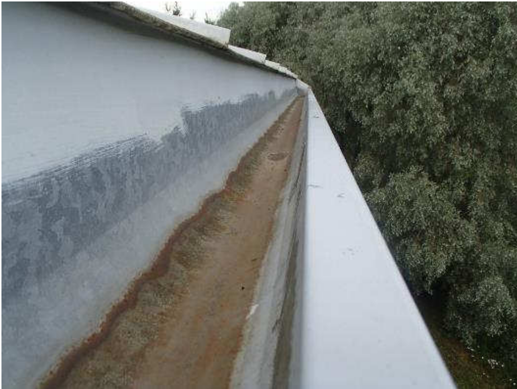
Kuva 101. Sadevesikourujen pohjat ovat ruostuneet.
