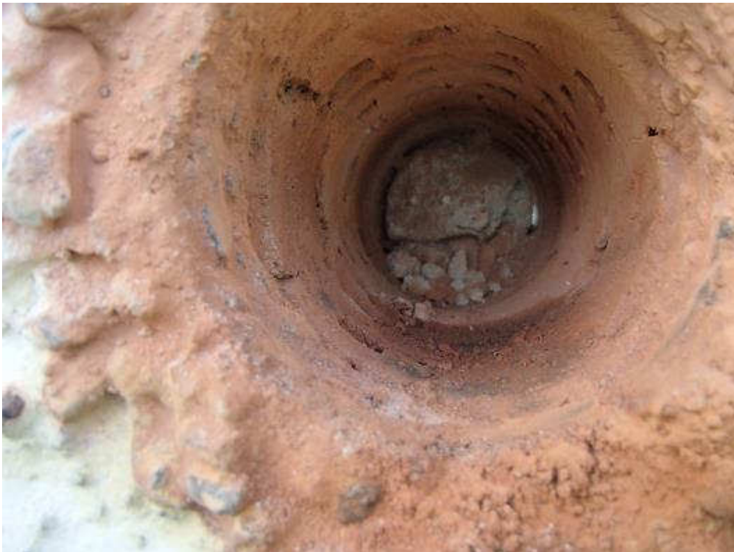
Kuva 12. Rakenneavauskohdissa ei havaittu rappausverkkoa.
