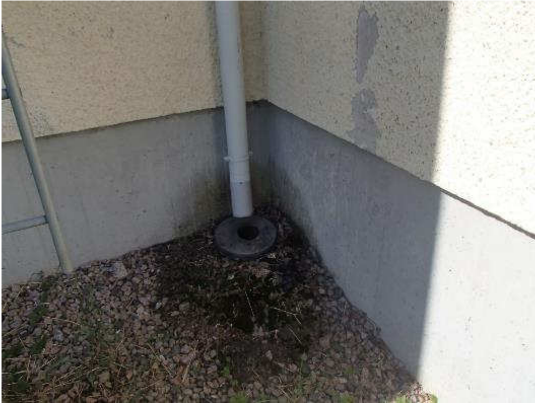
Kuva 92. Paikoin sadevedenpoisto rasittaa sokkelirakenteita.
