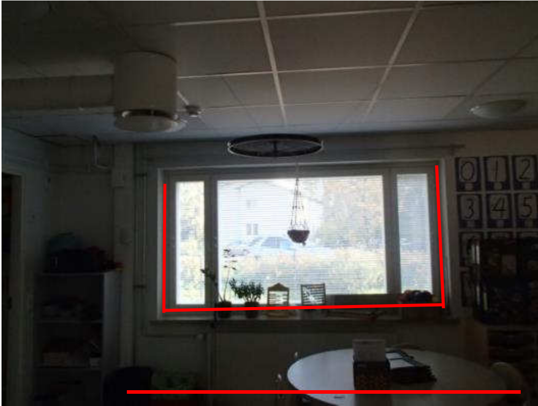
Kuva 137. Vuonna 1958 rakennetun koulurakennuksen tyypillisimmät epätiiveyskohdat.
