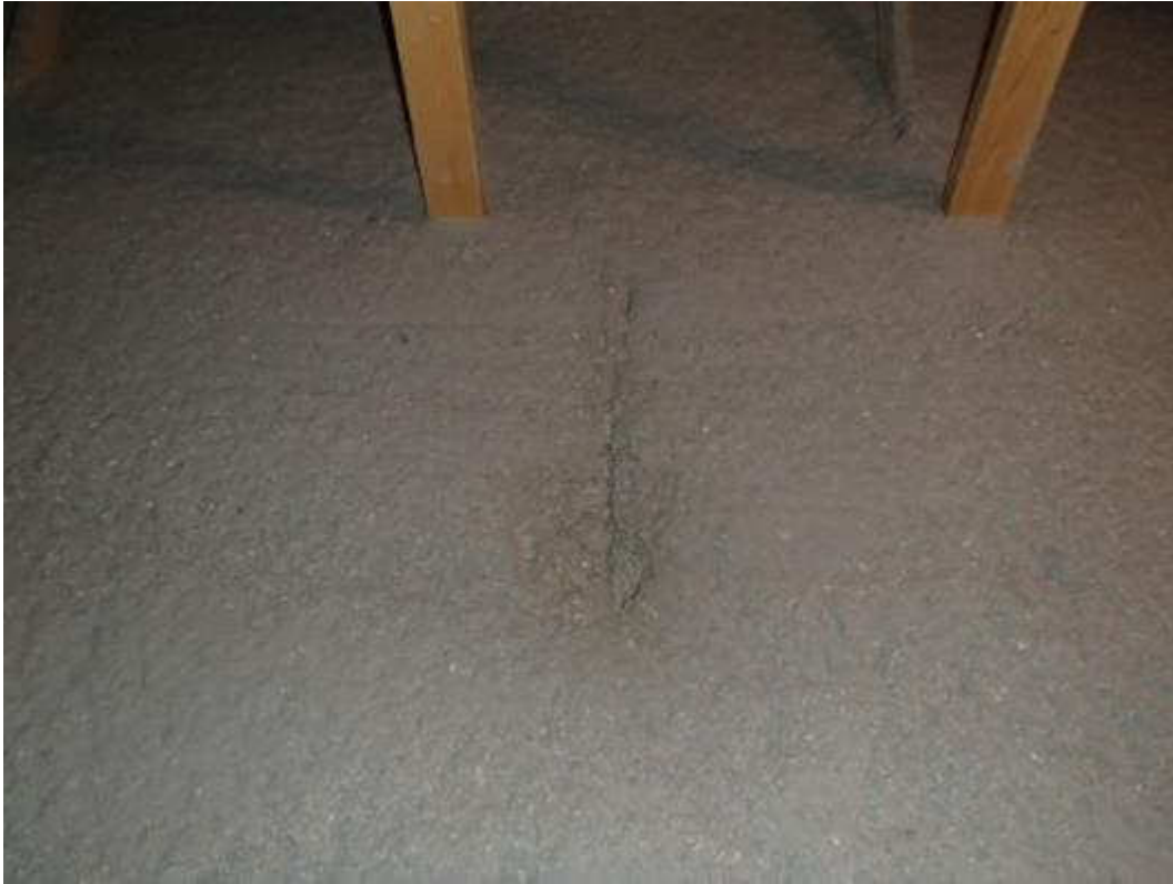
Kuva 132. Yhden tuulettuvan vinttitilan alipaineistajan alapuolella havaittiin vanhoja vesivuotojälkiä.
