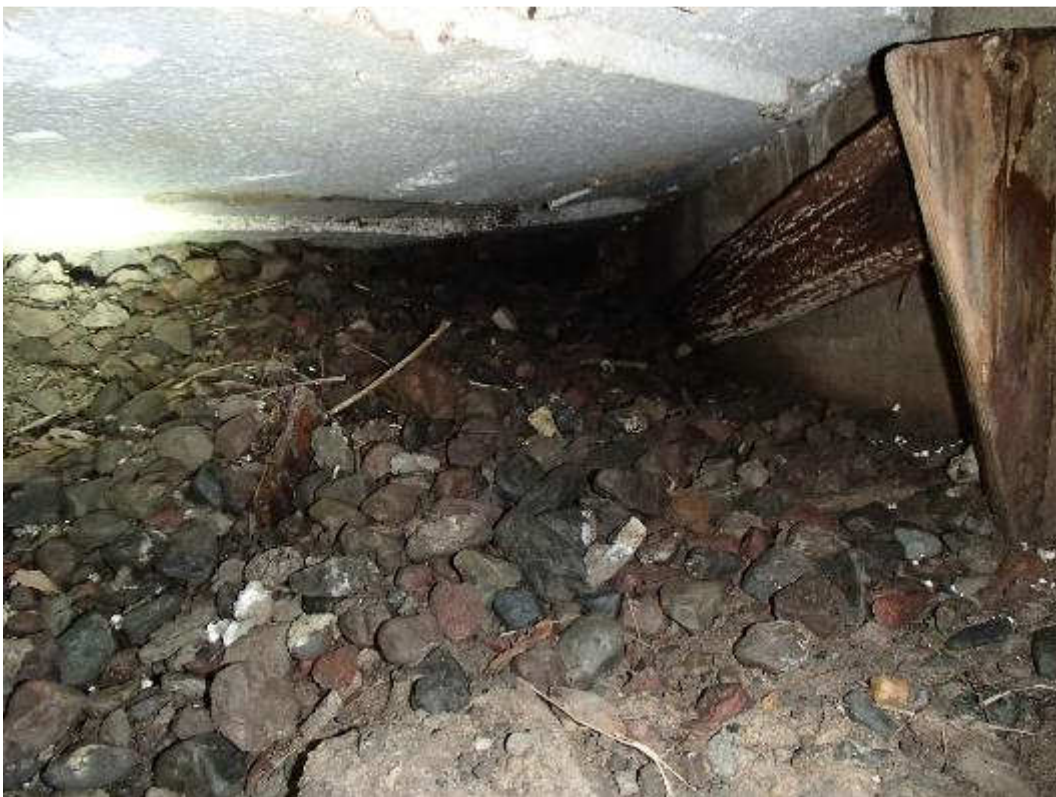
Kuva 120. Sade- ja sulamisvedet valuvat ryömintätilaan sokkelin edestä huuhtoen palkkien alapuoleiset hiekat ryömintätila puolella.
