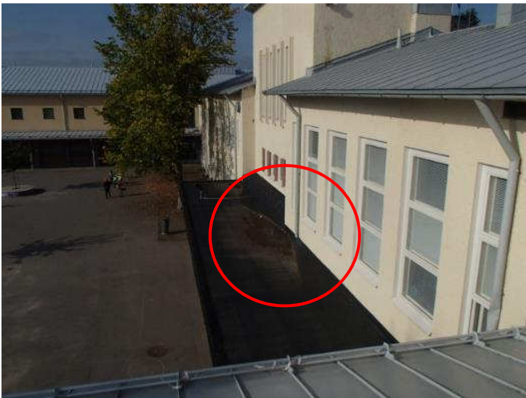
Kuva 37. Sadevesi lammikoituu sisäpihan katoksen päälle.
