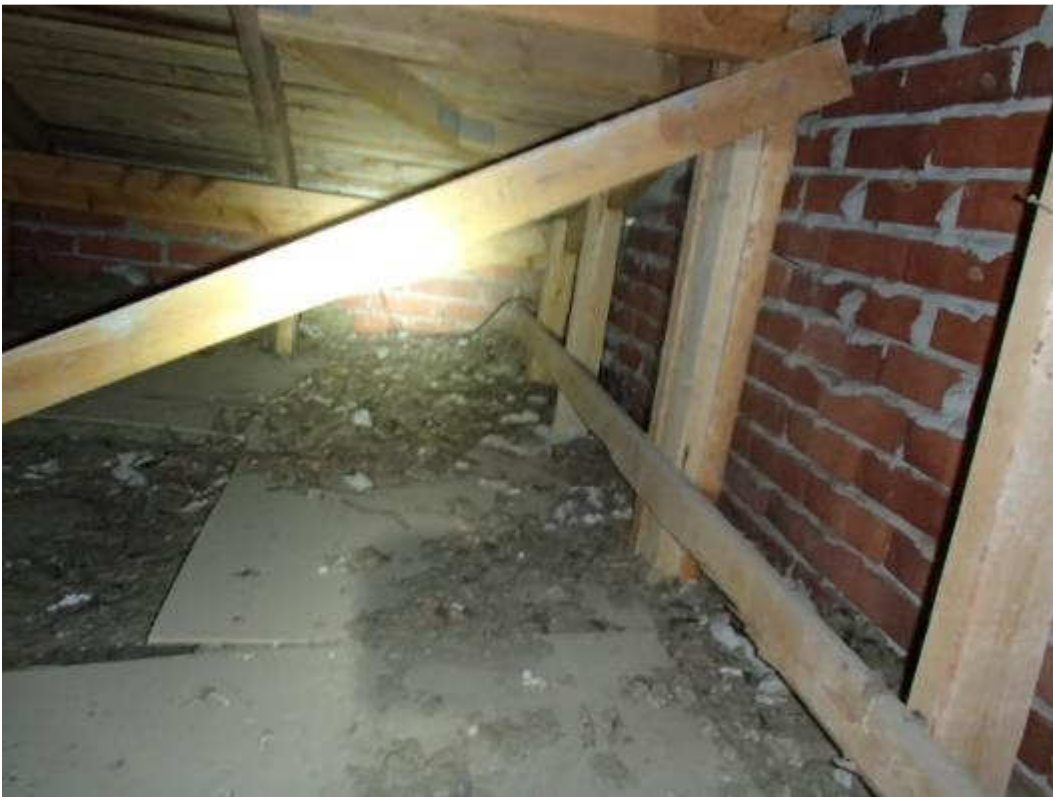
Kuva 104. Tuulettuvassa vintttilassa havaittiin paikoin runsaasti orgaanista jätettä.
