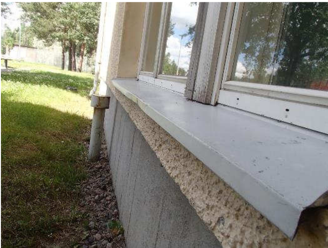
Kuva 93. Rakennuksen ympärillä olevat maapinnat kaatavat rakennusta kohden.
