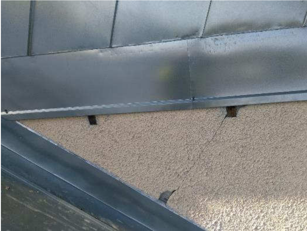
Kuva 28. Rakennuksen päädyssä on pellityksen alle jätetty vanhat vesikaton runkopuu esiin.
