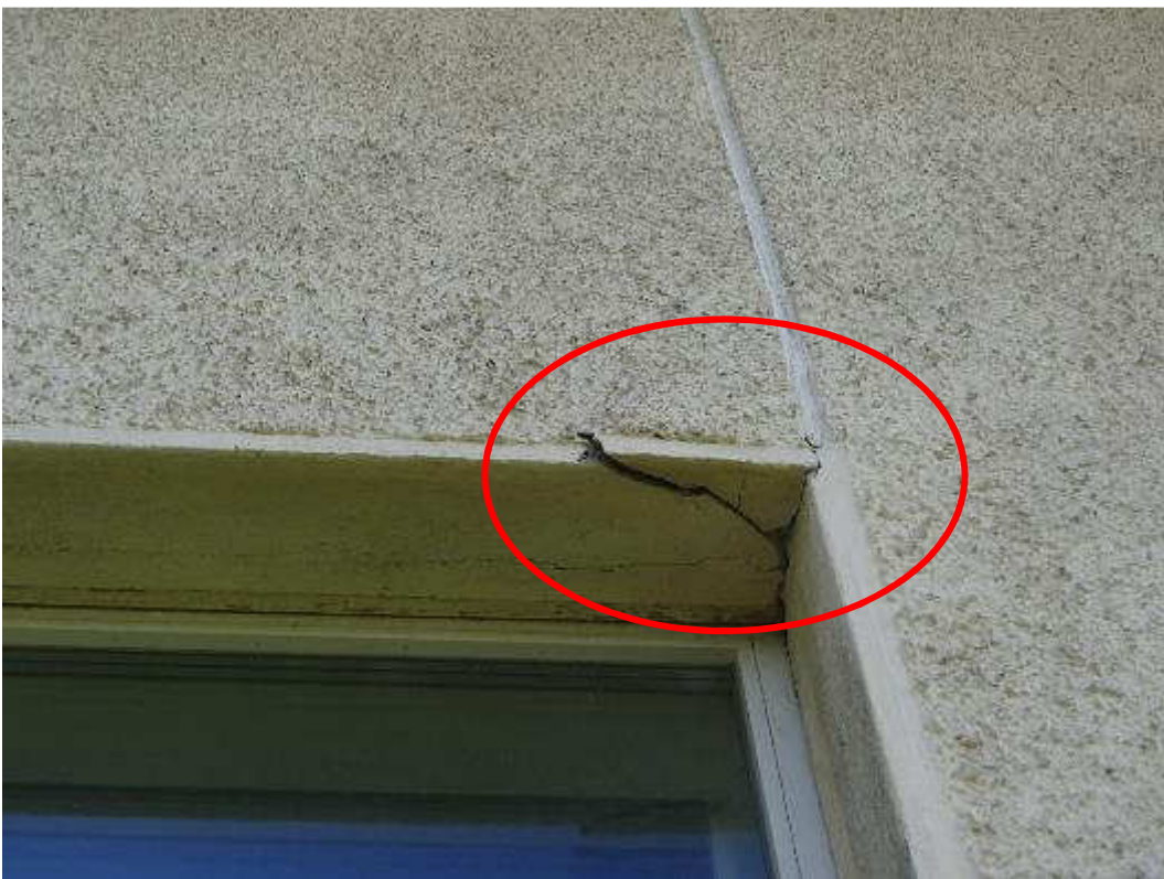
Kuva 79. Paikoin julkisivuista on irtoamassa palasia.
