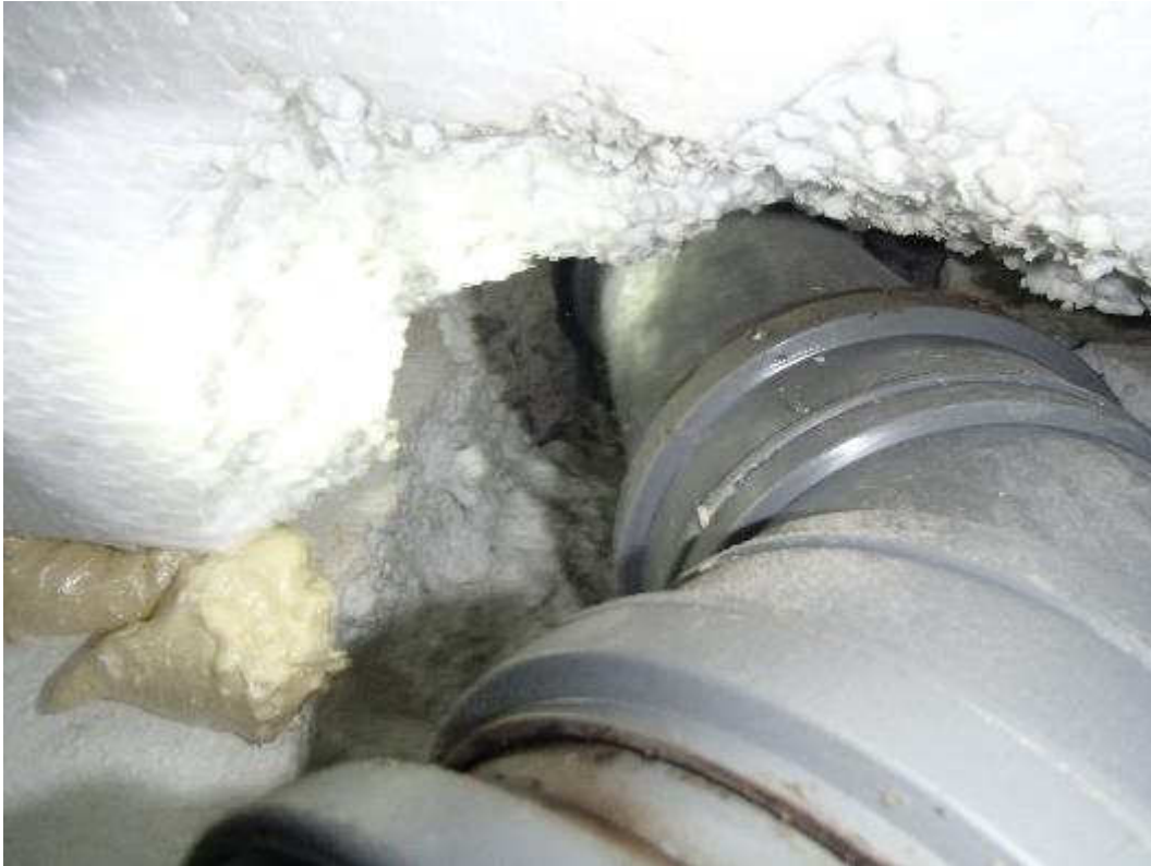
Kuva 123. Alapohjan läpiviennit eivät ole tiiviitä.
