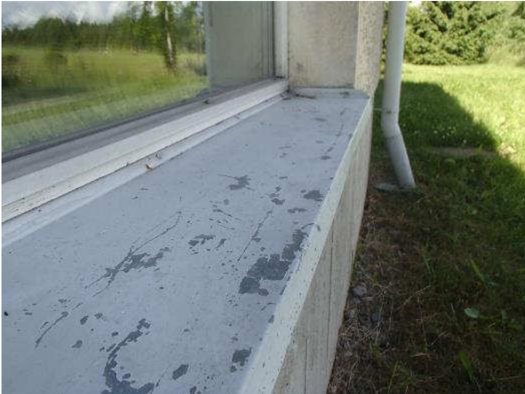
Kuva 85. Ikkunoiden vesipellit kaatavat kohden rakennusta.
