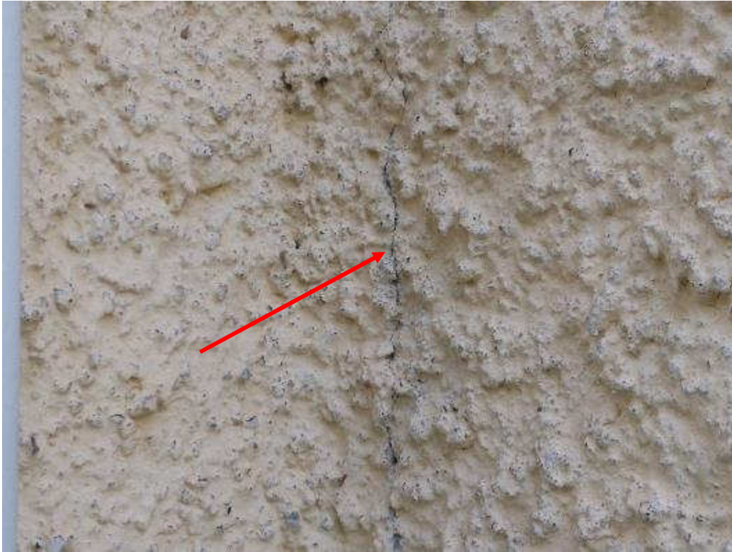
Kuva 80. Julkisivupinnoilla havaittiin paikoin halkeilua.
