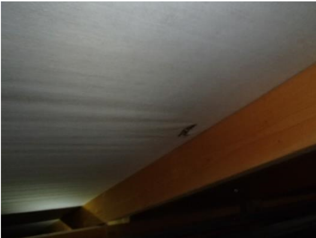
Kuva 133. Vesikatteen alapuoleisessa aluskatteessa havaittiin paikoin reikiä.
