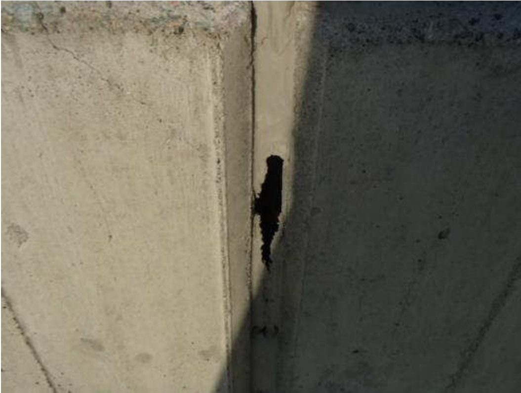
Kuva 126. Sokkelielementtien väliset elastiset saumamassat ovat paikoin rikkoituneet ja ikääntyneet.
