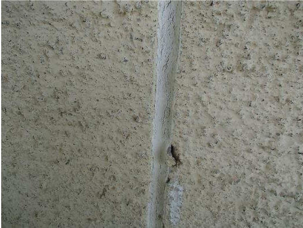
Kuva 88. Julkisivujen elastiset saumamassat ovat ikääntyneet.
