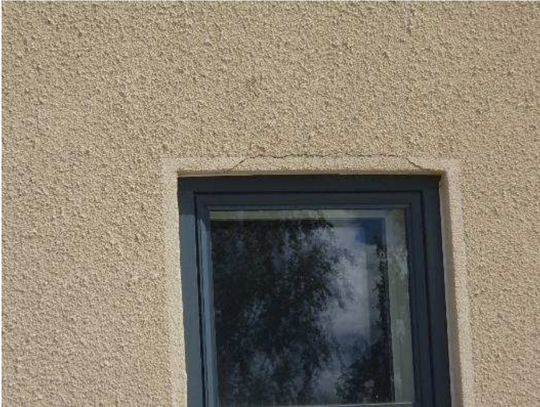
Kuva 130. Julkisivupinnoissa havaittiin halkeilua.
