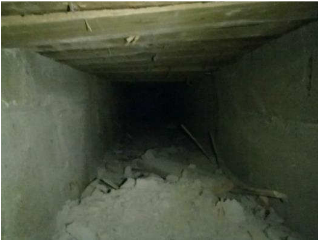
Kuva 35. Luokahuoneiden yläpuoleisessa yläpohjassa kulkee rakenteellisia IV-kanavistoja, joissa on roskaa, likaa ja muottilauoituksia.
