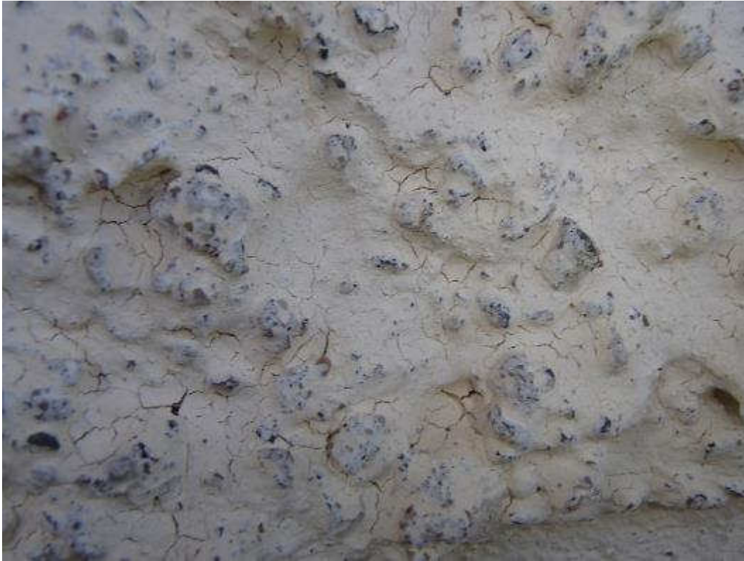
Kuva 82. Julkisivujen maalipinnoissa havaittiin mikrohalkeilua.
