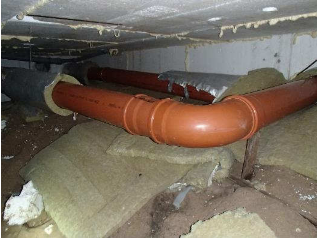
Kuva 121. Viemäriputkistojen lämmöneristeet ovat irtoilleet.
