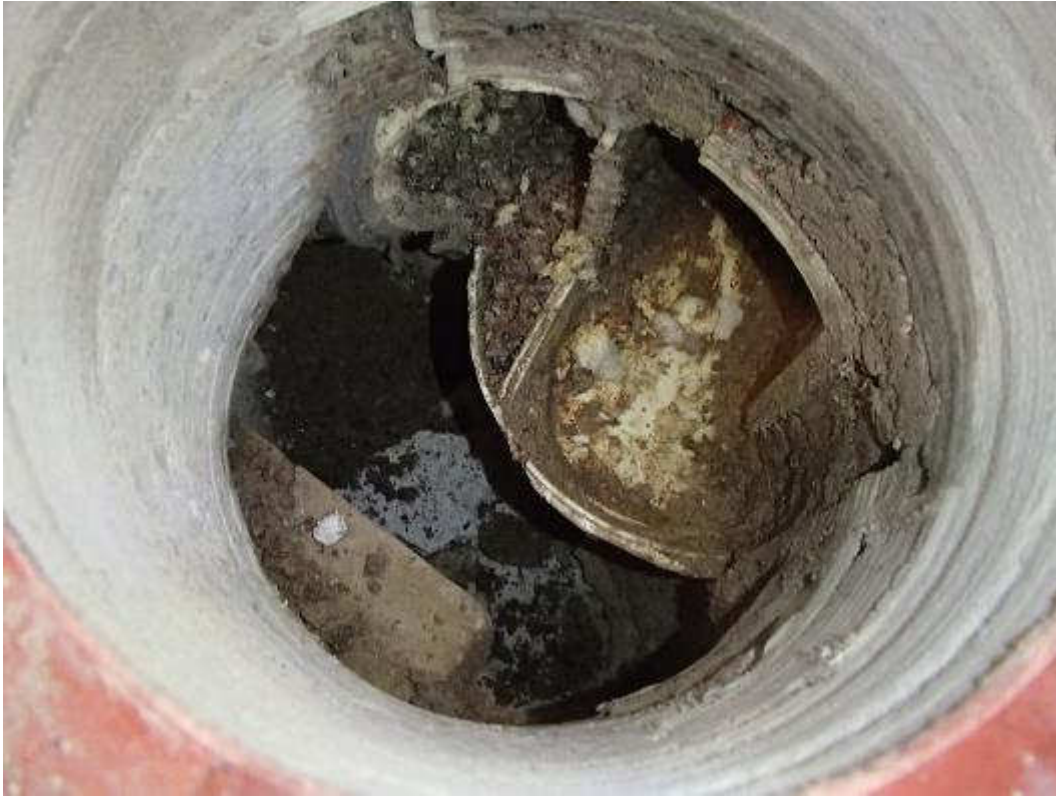
Kuva 55. Esikoulun välipohjan rakenneavauksessatuli vastaan käytöstä poistettu lattiakaivo ja täyteenä välipohjassa oli betonia, hiekka ja puupalasia.
