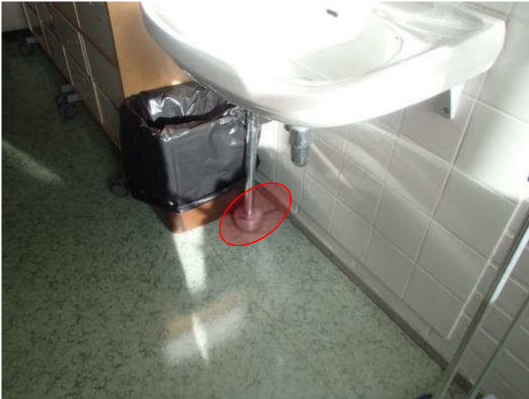
Kuva 139. Alapohjan tyypillisimmät epätiivetykohdat.
