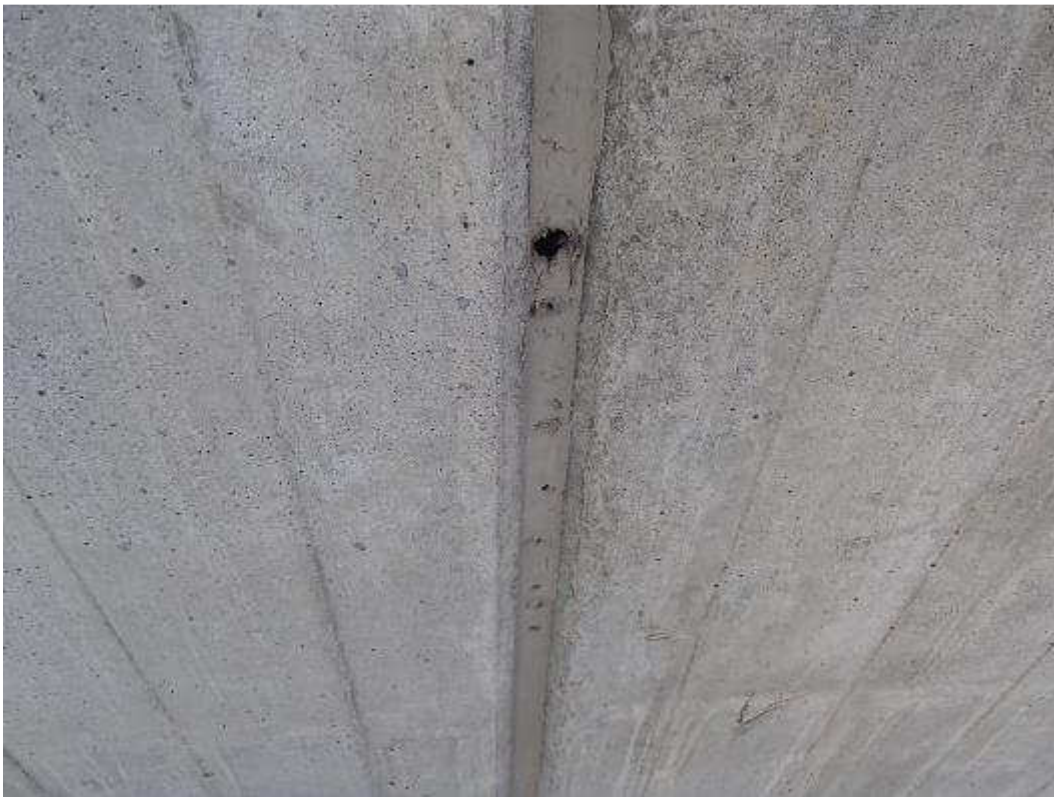
Kuva 125. Sokkielementtien väliset elastiset saumamassat ovat vaurioituneet ulkopuolisten tekijöiden seurauksena.
