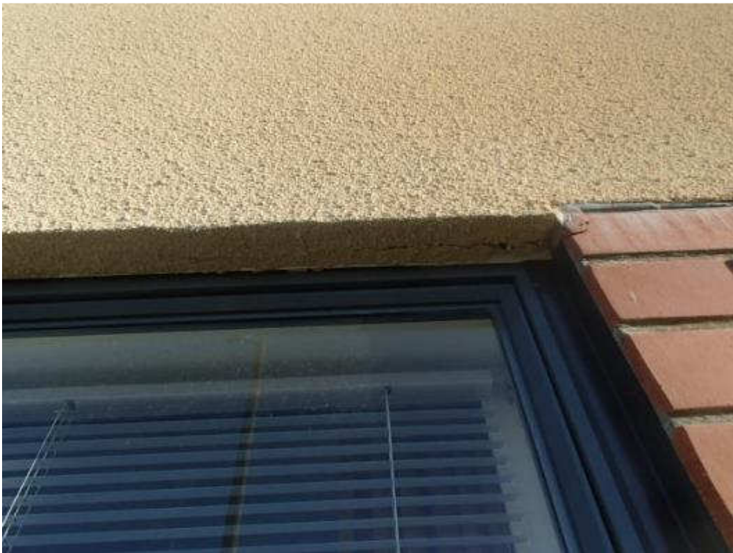
Kuva 131. Ikkunoiden pielissä havaittiin halkeilua.
