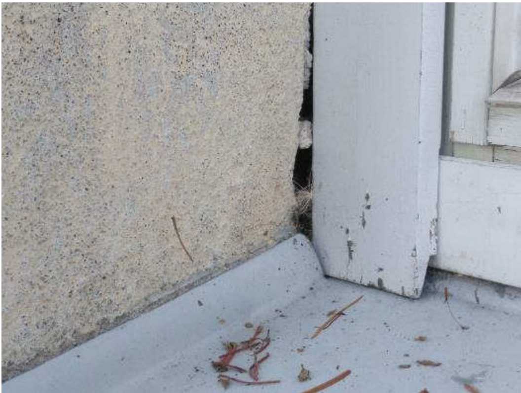
Kuva 83. Ikkunoiden ja pielirakenteiden rajapinnoilla havaittiin rakoja rakenteisiin.
