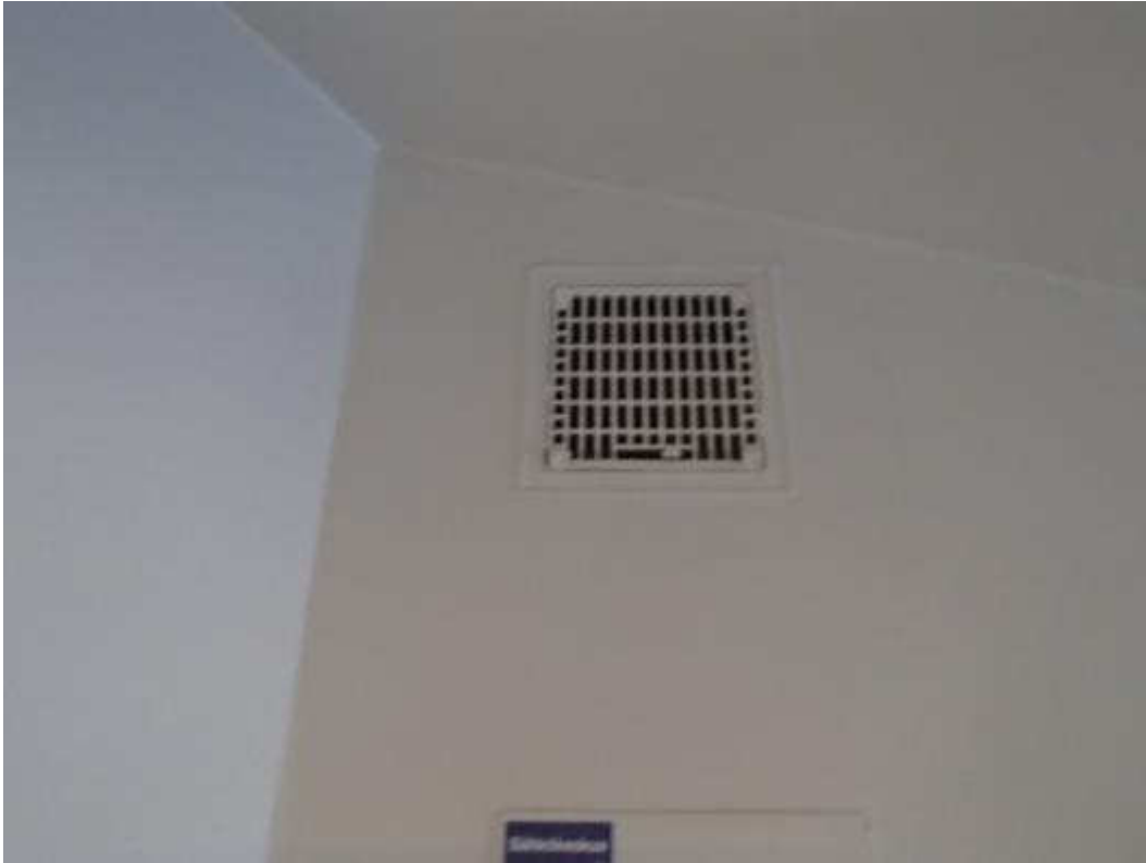
Kuva 36. Paikoin sisätiloissa havaittiin vanhoja IV-kanavien pääte-elimää.
