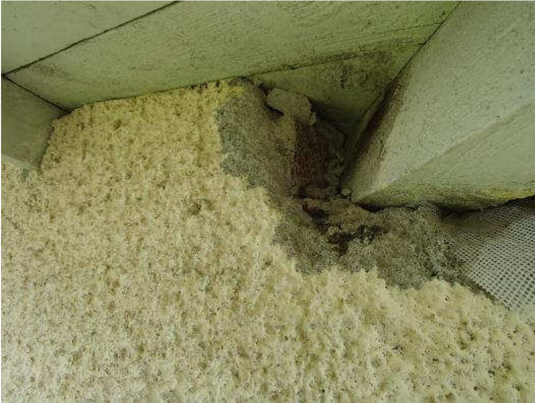
Kuva 78. Julkisivuista on paikoin irronnut palasia.
