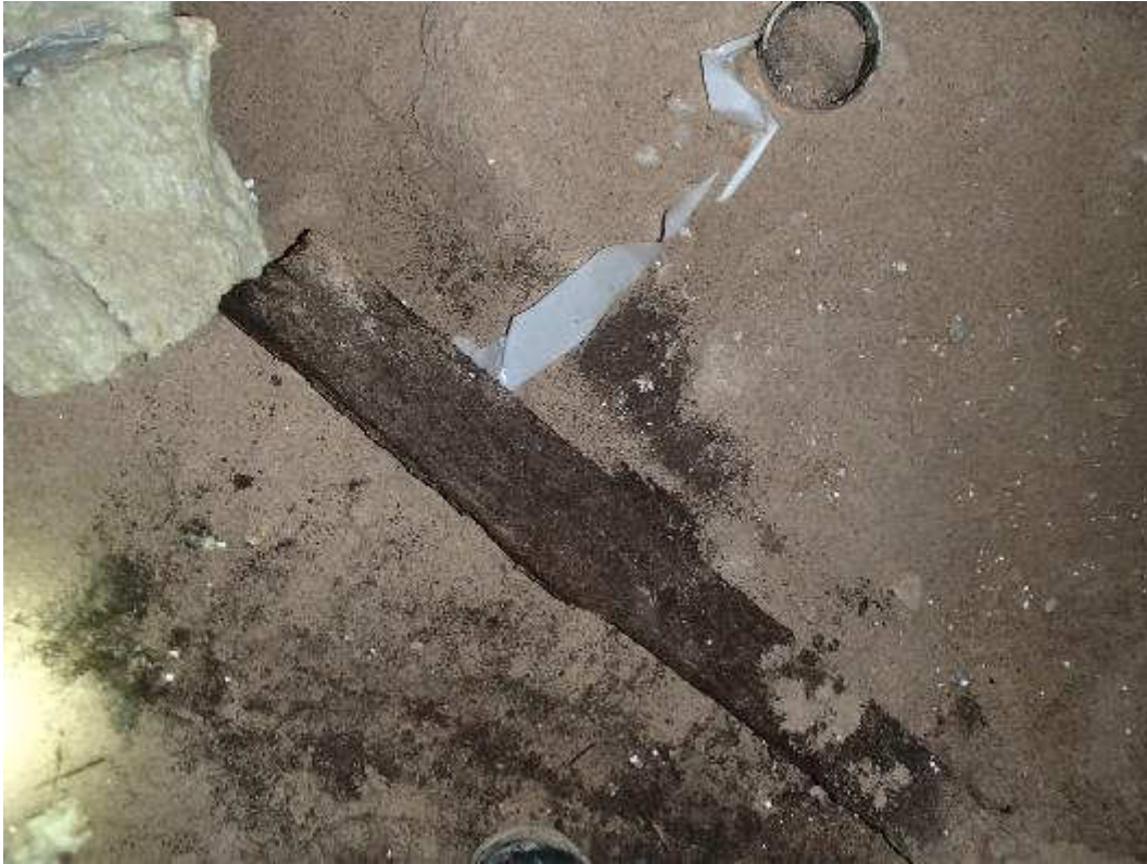
Kuva 115. Ryömintätilassa havaittiin rakennusaikaisia lahonneita puumateriaaleja.
