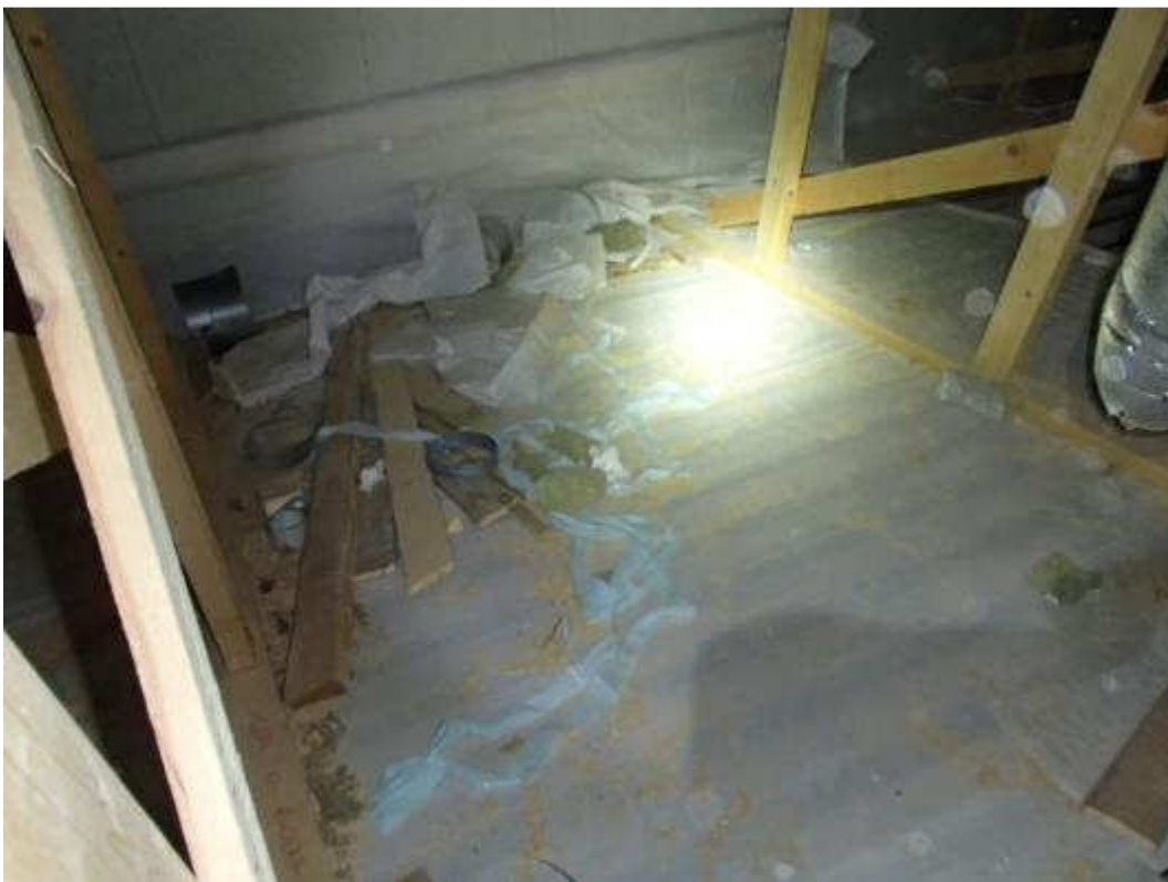
Kuva 106. Tuulettuvassa vintttilassa havaittiin rakennusaikaista roskaa.
