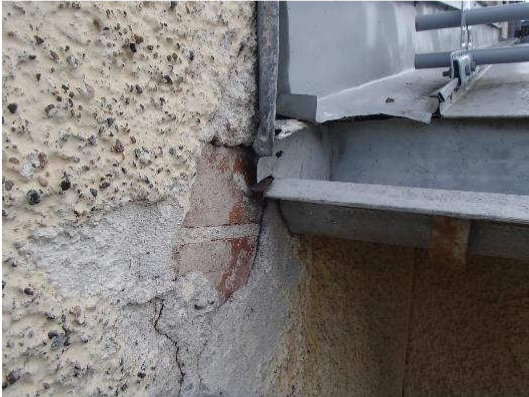
Kuva 11. Vesi on ohjautunut pellityksien ja sadevesikourujen kautta julkisivuille vaurioittaen rappauspintoja.
