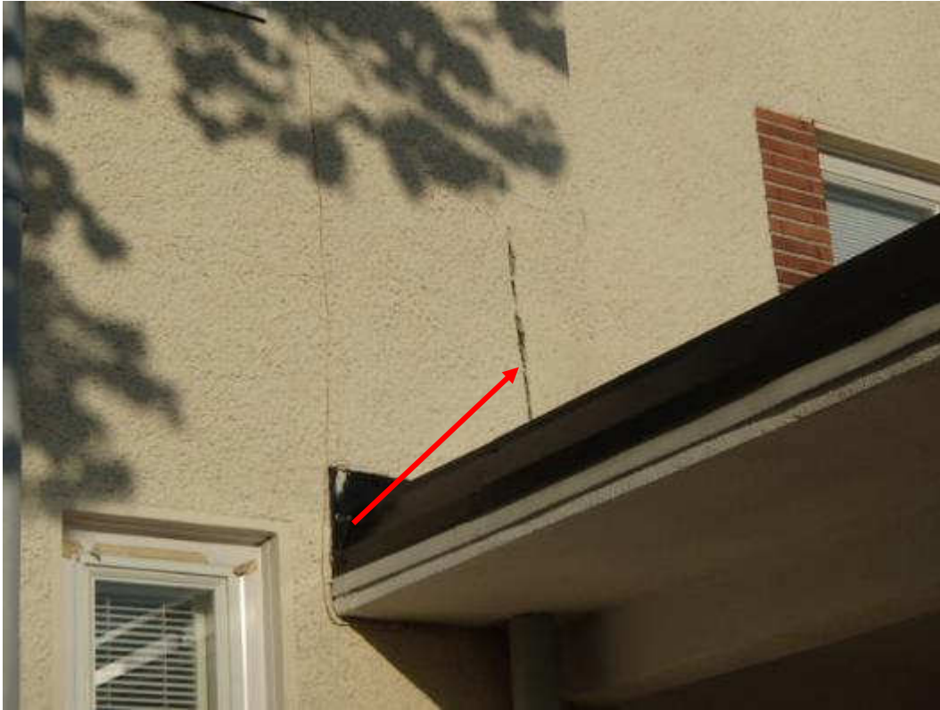
Kuva 15. Julkisivuilla havaittiin avoimia liikuntasauvoja.
