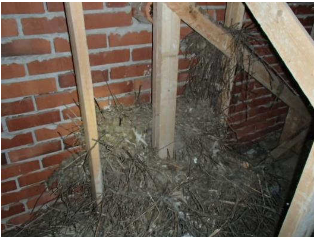
Kuva 102. Tuulettuvassa vintttilassa havaittiin massiivisia linnunpesiä.
