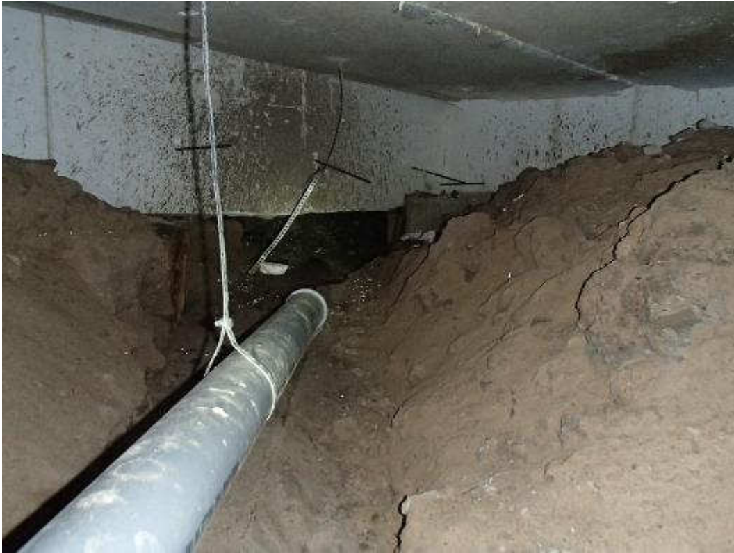
Kuva 119. Sade- ja sulamisvedet valuvat ryömintätilaan sokkelin edestä.
