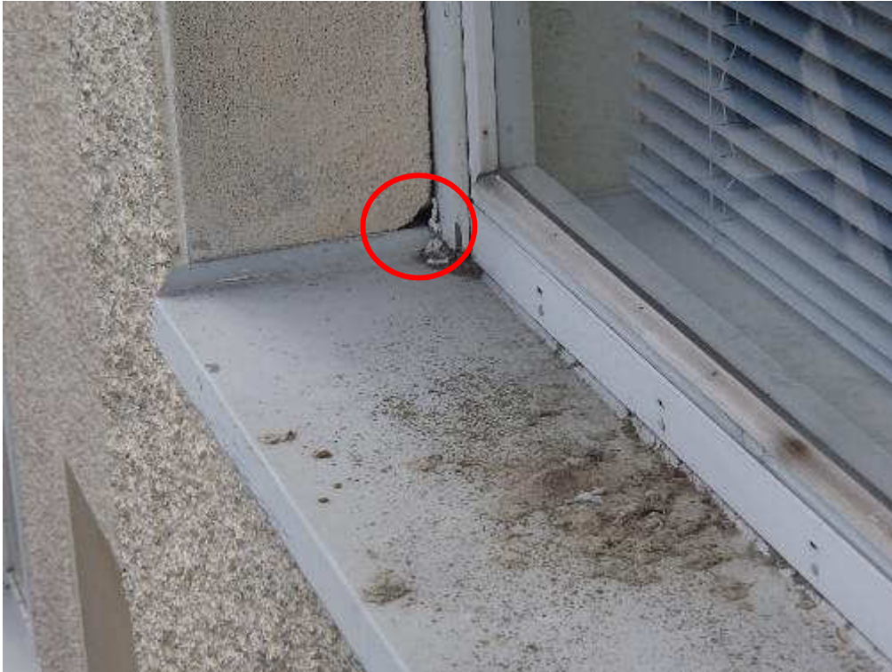
Kuva 84. Ikkunoiden vesipellit kaatavat paikoin kohden rakennusta ja vesipeltien kulmissa on rakoja rakenteisiin.
