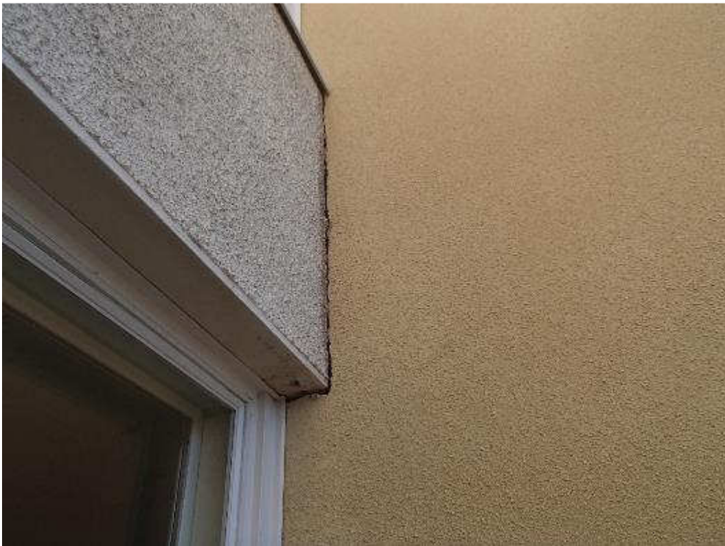
Kuva 87. Rakennuksien rajapinnoilla on avoimia rakoja rakenteisiin.
