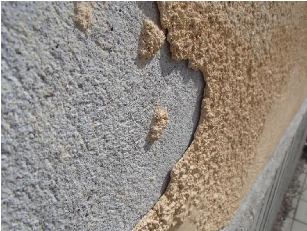
Kuva 129. Julkisivupintojen pintarappaus on paikoin irronnut alustastaan.
