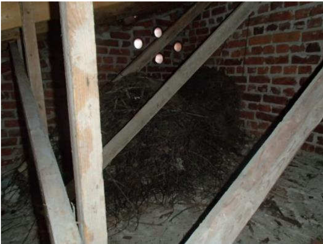
Kuva 31. Tuulettuvassa vinttitilassa on massiivinen linnunpesä.
