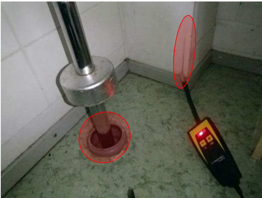
Kuva 141. Alapohjan tyypillisimmät epätiiveyskohdat.
