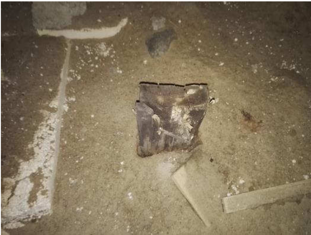
Kuva 114. Ryömintätilassa havaittiin rakennusaikaisia lahonneita puumateriaaleja.
