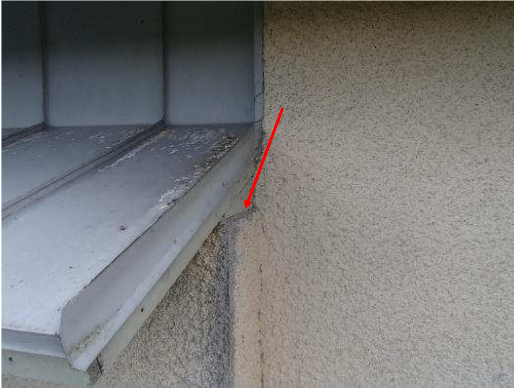
Kuva 86. Paikoin julkisivujen pellitykset ovat riittämättömät.
