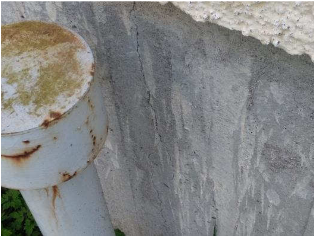
Kuva 89. Sokkelissa havaittiin pystysuuntaista halkeilua.
