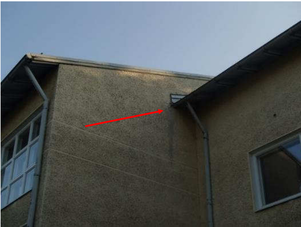
Kuva 10. Sadevesi on paikoin kuluttanut julkisivupintoja.
