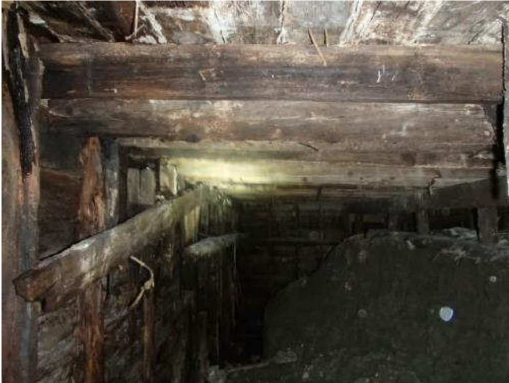
Kuva 72. Esikoulun alapuoleisen ryömintätilan muottilaudoitukset ovat pahoin vaurioituneet.
