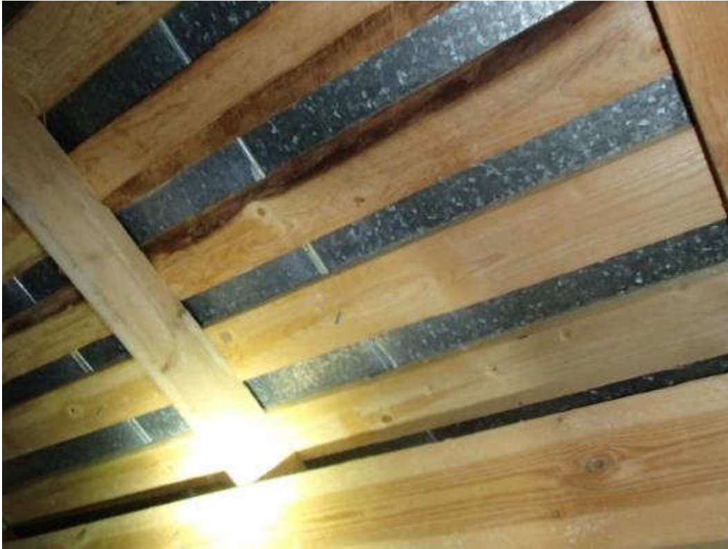
Kuva 105. Vesikatteen alapuolella ei ole aluskatetta.
