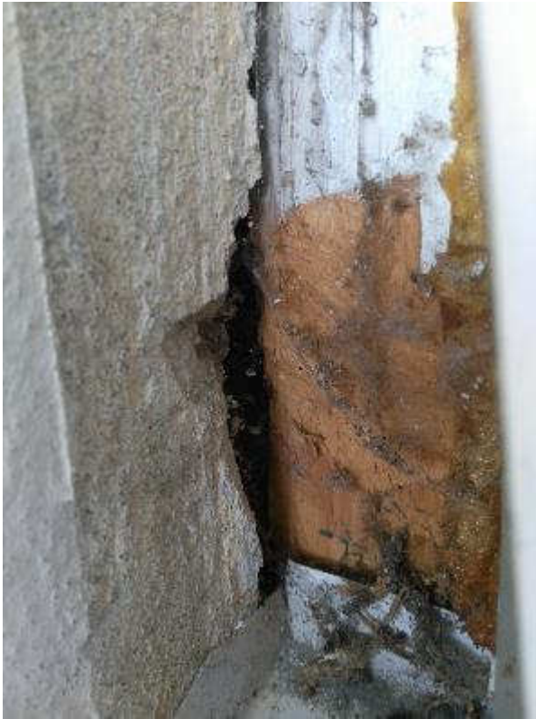
Kuva 13. Ikkunaremontin yhteydessä vanhat karmit on jätetty rakenteisiin.
