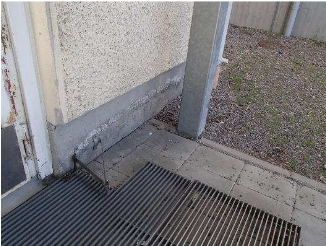
Kuva 91. Sokkelipinnoissa havaittiin kalkkihärmekertymiä.
