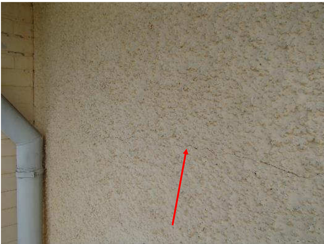
Kuva 8. Rakennuksen rappauspinnoissa havaittiin paikoin halkeilua.
