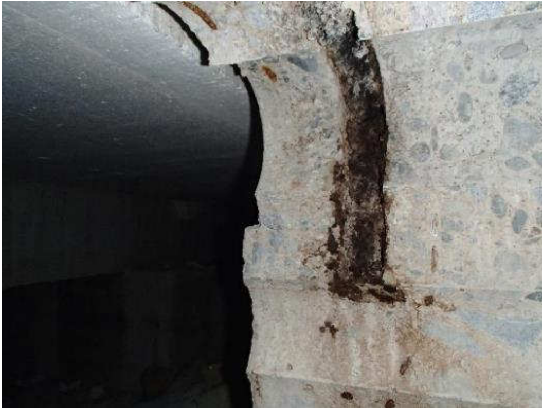
Kuva 19. Rakennuksen sokkelihalkaisussa havaittiin vaurioituneet korkkieristeet.
