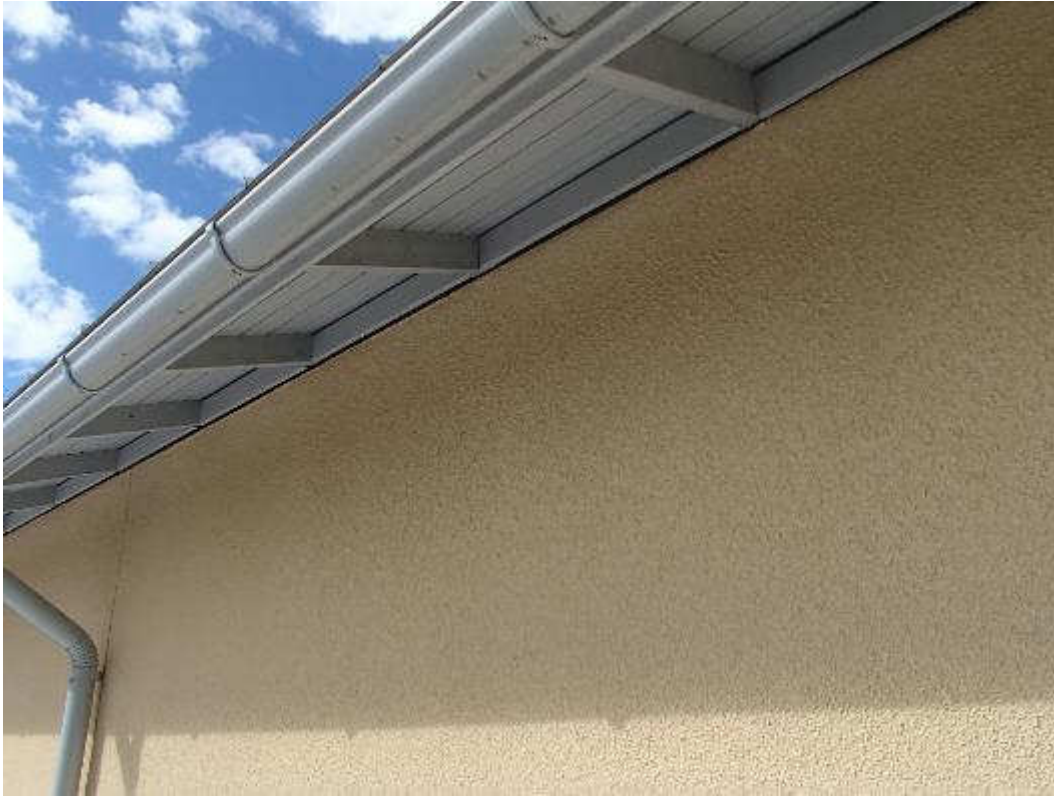
Kuva 134. Julkisivujen ja yläpohjan rajapinnalla ei havaittu myrskypellitystä.
