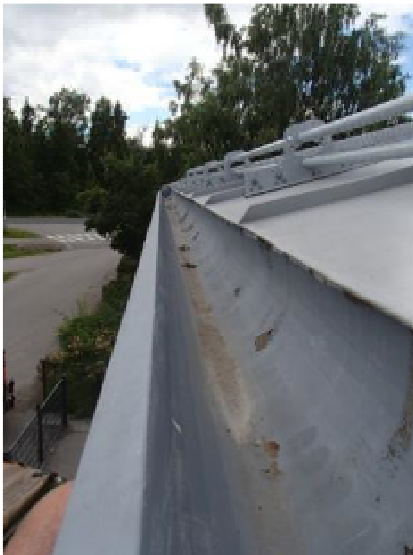
Kuva 27. Sadevesikouruissa havaittiin paikallista korroosiota.
