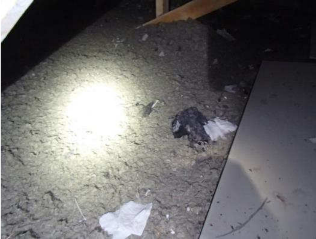
Kuva 103. Tuulettuvassa vintttilassa havaittiin linnun raatoja.
