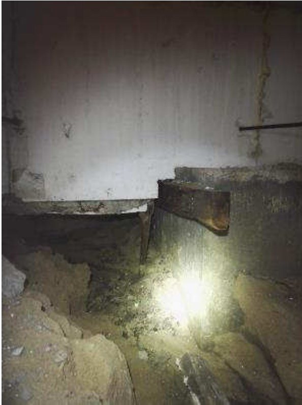
Kuva 113. Ryömintätilassa havaittiin rakennusaikaisia lahonneita puumateriaaleja.
