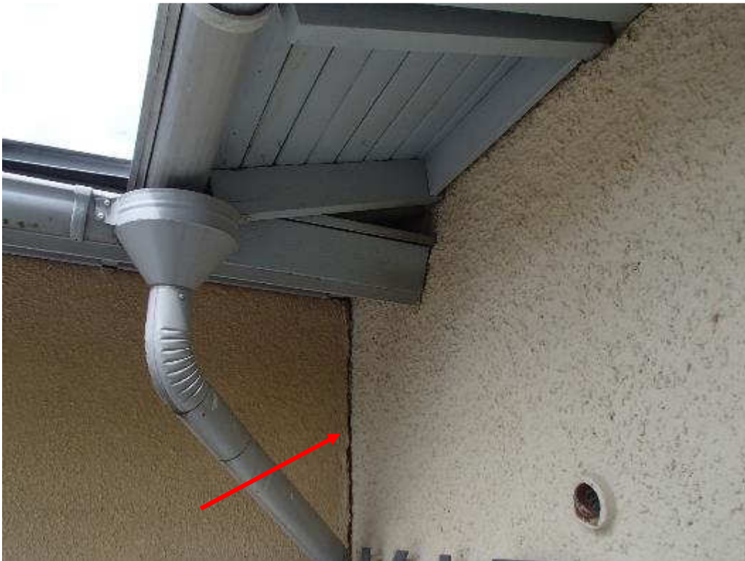
Kuva 14. Eri rakennuksien liitoskohtien rajapinnoilla on avoimia saumoja rakenteisiin.
